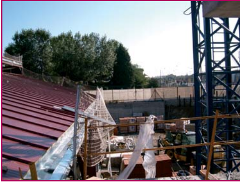
Red mal colocada
