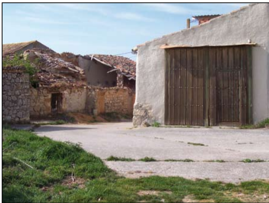
Edificio en ruinas en un municipio segoviano.
